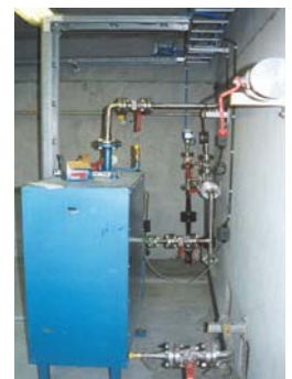
Gass- og vannrør- installasjon til gass- kjel i boligområde
